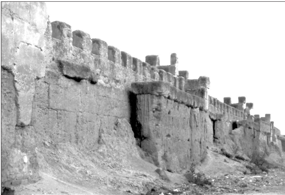
Fig. 8: Côté oriental de la muraille, façade intérieure: dégradation avancée du chemin de ronde, (© Kafas, 1999).
