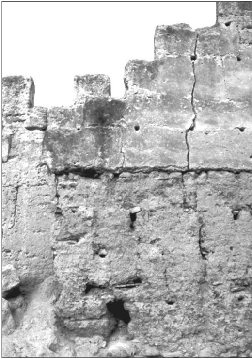
Fig. 7: Côté oriental de la muraille, façade intérieure, longrine disposée horizontalement dans la maçonnerie du mur pour lui assurer plus de cohésion.
