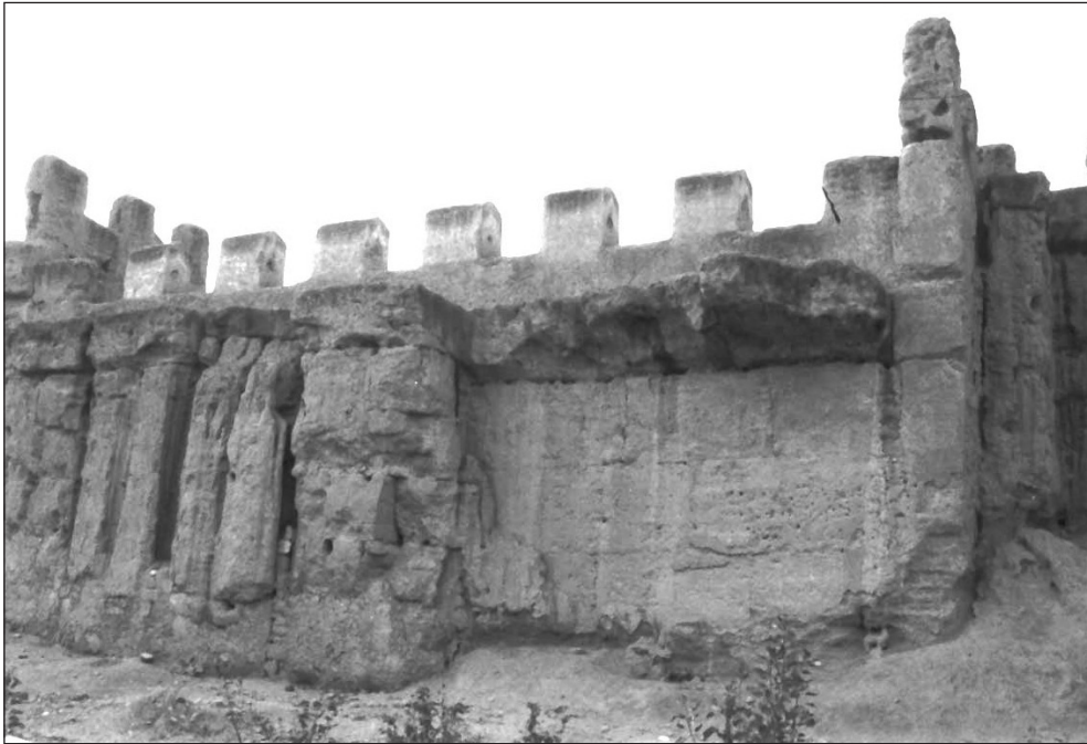
Fig. 5: Détail de la maçonnerie constitutive des courtines et du chemin de ronde (côté oriental de la muraille, façade intérieure), (© Kafas, 1999).
